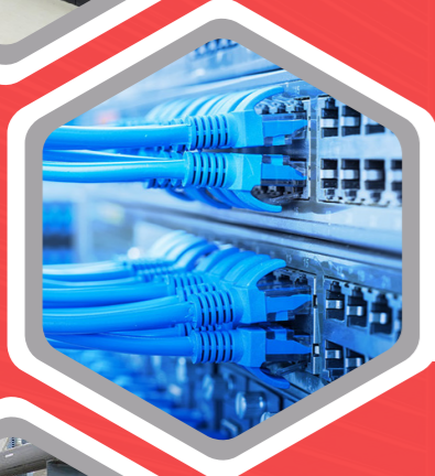
HỆ THỐNG ĐIỆN NHỆ
